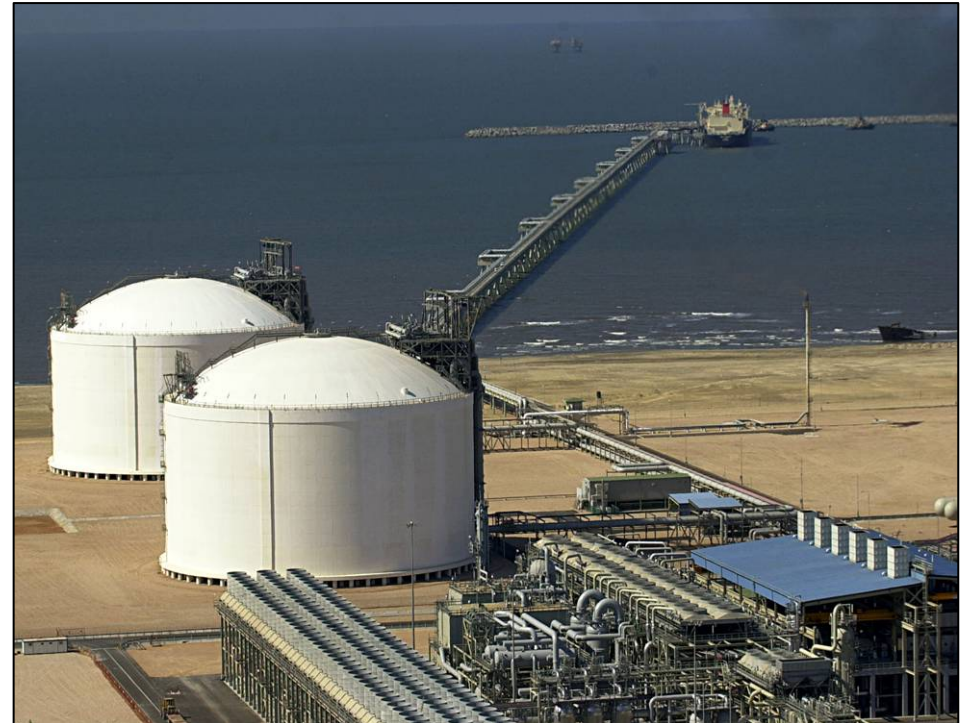
BG Group's LNG liquefaction plant, Idku, Egypt
